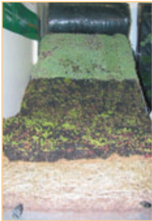
Le toit végétal, un isolant efficace été comme hiver.
